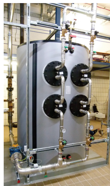
Abb.: Anlage mit CAPITO M-PD 3000
