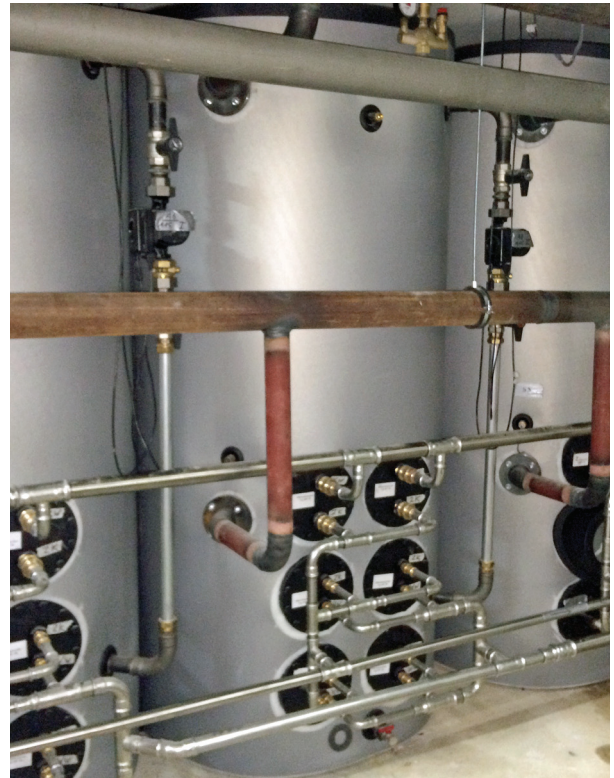
Abb.: Trinkwasseranlage mit 3 CAPITO Pufferspeicher 2-Zonen-PD 750
