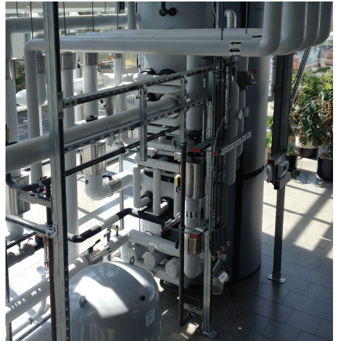
Abb.: CAPITO 3-Zonen-PD 5000 mit Gaskessel, Heizzentrale REHAU AG
