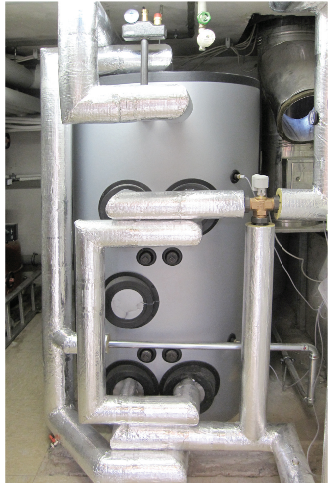
Abb.: Fernwärme-UNI-PS 750 im Elsberghaus
