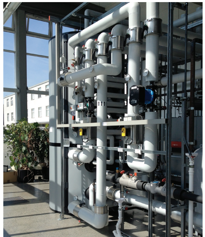
Abb.: CAPITO 3-Zonen-PD 5000 in der Heizzentrale der REHAU AG
