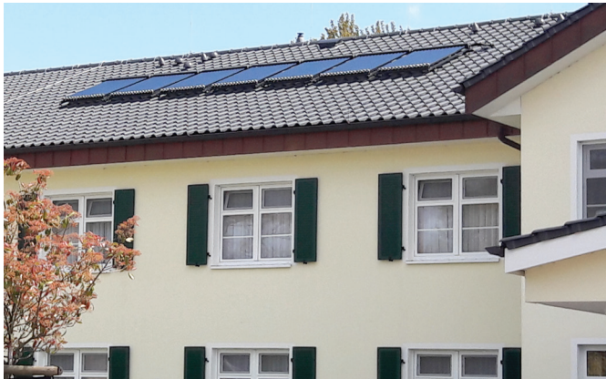
Abb.: Kollektoranlage mit 7 Röhrenkollektoren CC HPV 15
