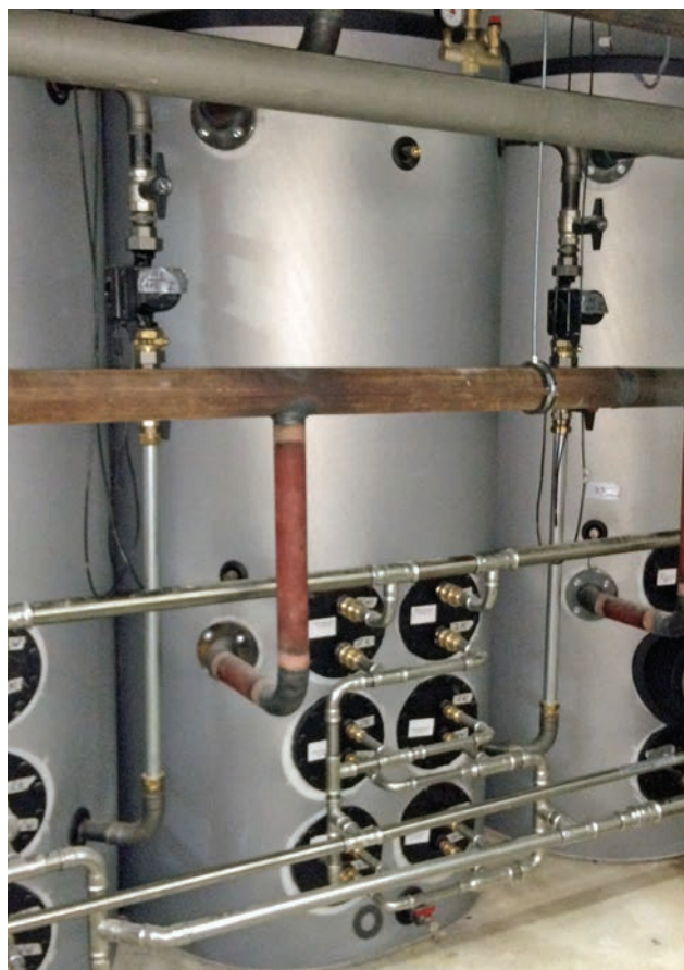
Abb.: Trinkwasseranlage mit 3 CAPITO Pufferspeicher 2-Zonen-PD 750
