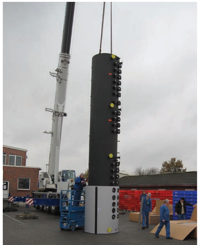
Abb.: Einbau erfolgte aufgrund der Größe der 6 Pufferspeicher mit Hilfe eines Krans durch das Dach des Gebäudes
